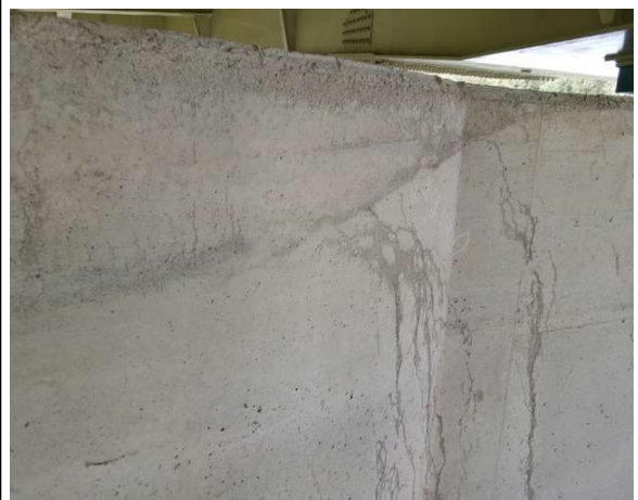
위 치 교각 P12 현 황 표면박리( A=3.5\text{m}\times2.0\text{m} )
