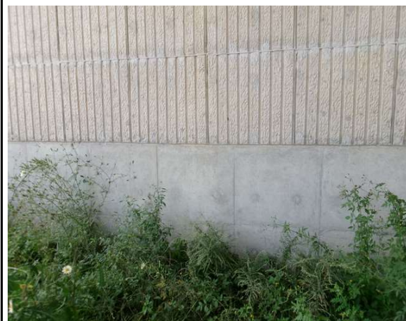
위 치 교대 A2 현 황 균열( C_w>0.3\text{mm} )
