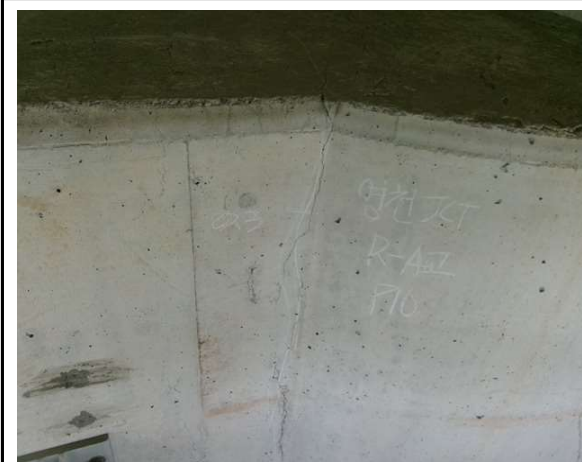
위 치 교각 P10 현 황 균열( C_w>0.3\text{mm} )
