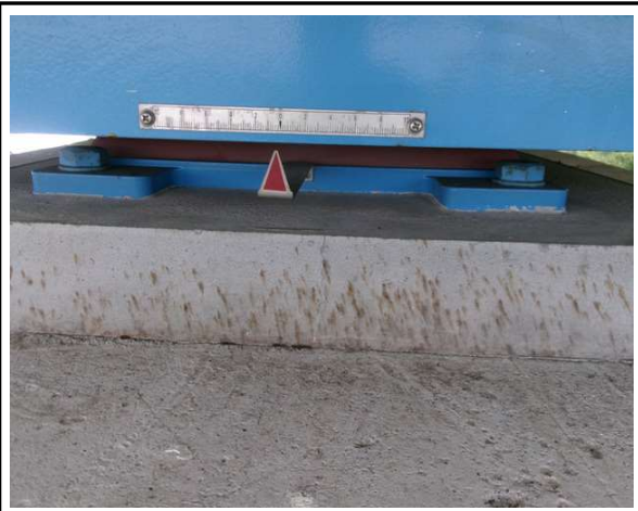
위 치 교량받침 P13-SH2 현 황 무수축물탈 균열( C_w<0.3\text{mm} )
