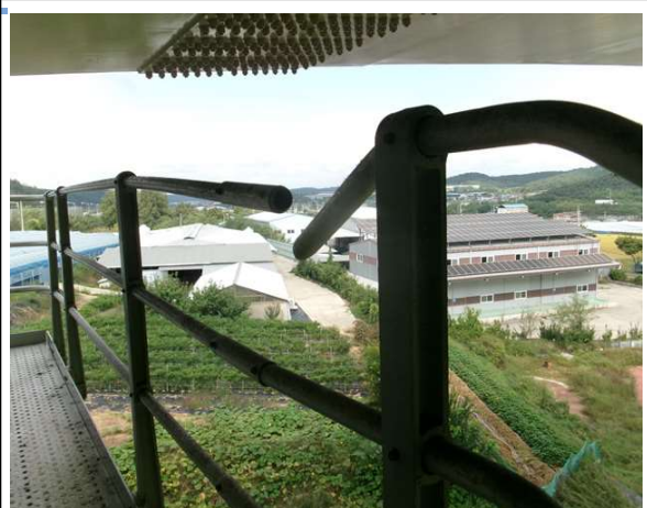
위 치 교각 P12 현 황 점검로 난간파손
