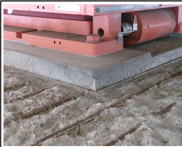
위 치 교량받침 P08-SH1 현 황 무수축물탈 박리( A=0.1\text{m}\times0.1\text{m} )
